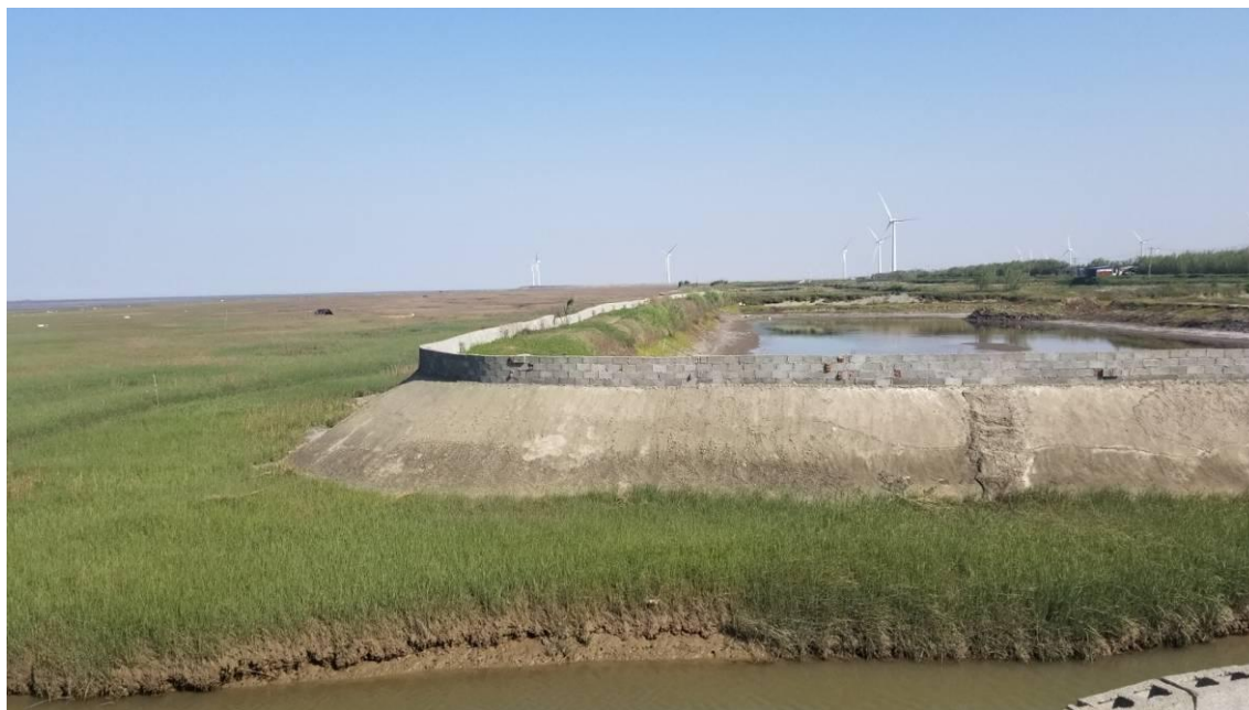
图 1.1-4 典型堤防现状
